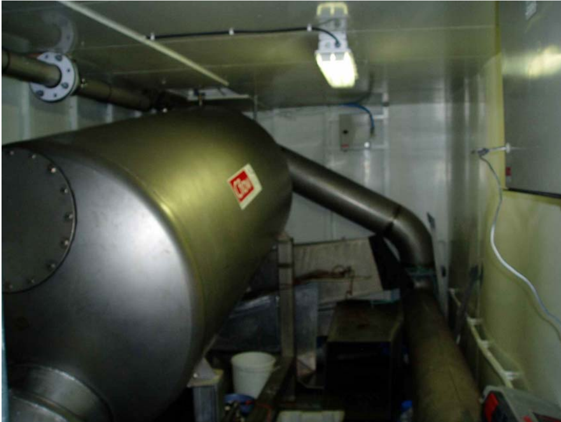
Bilde 23 Fartøyet har et eget rom for vakuumentank og ventiler på hoveddekket
